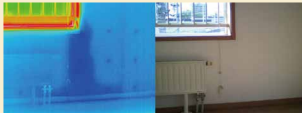
▲ 暖房機の配管もれ
