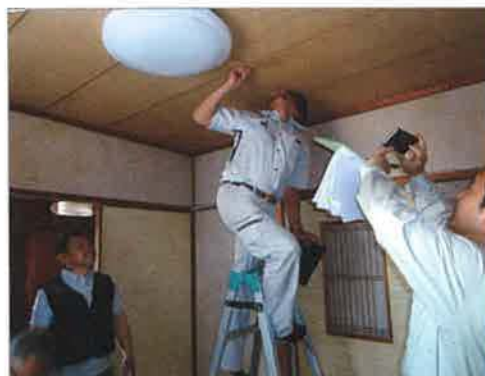
脚立に乗って天井の仕上げ面の染みを確認する
