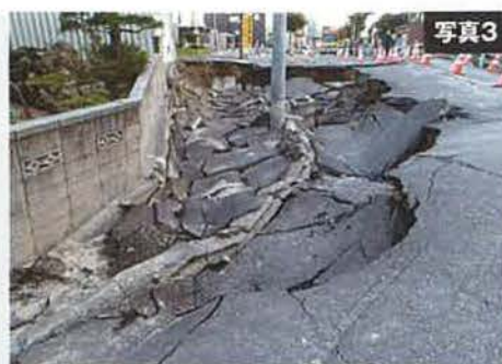
国道36号線と旧国道を結ぶ道路。崩れ落ちたアスファルトの残骸が大量に散らばっていた。写真1、2の上流側に位置していることから、アスファルトの下の土砂は低地に向かって流れたものと思われる。
